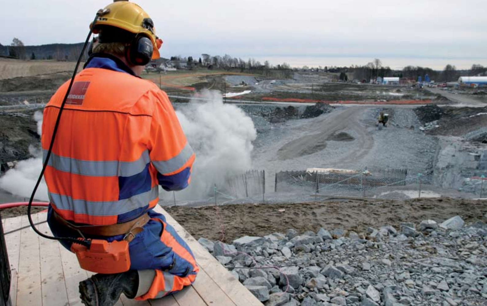
Tunnelbas Reidar Silliløkken har kontroll på sprengkraften som Orica leverer. Korte salver bremser framdrifta, men er nødvendig av hensyn til bebyggelsen.
