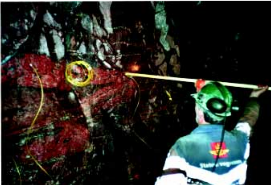
Lading av pilot med Nonel LP/MS og Dynotex i.h.t. plan i tunnellop B 1000
