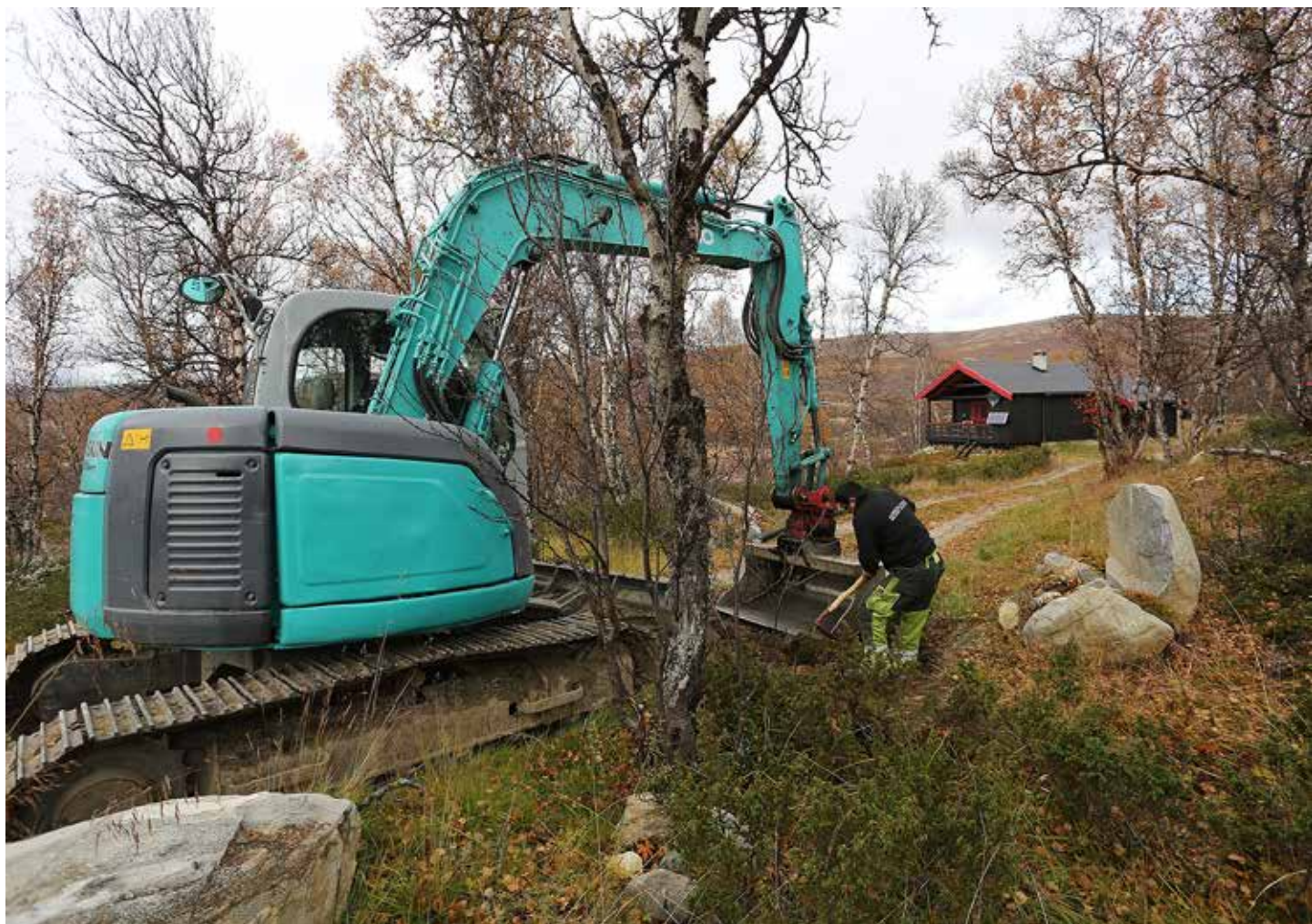
Oppdragene varierer fra timesjobber til store prosjekter. Her graves stikkrenne for en hytteeier i bjørkeskogen på Hjerkin.
