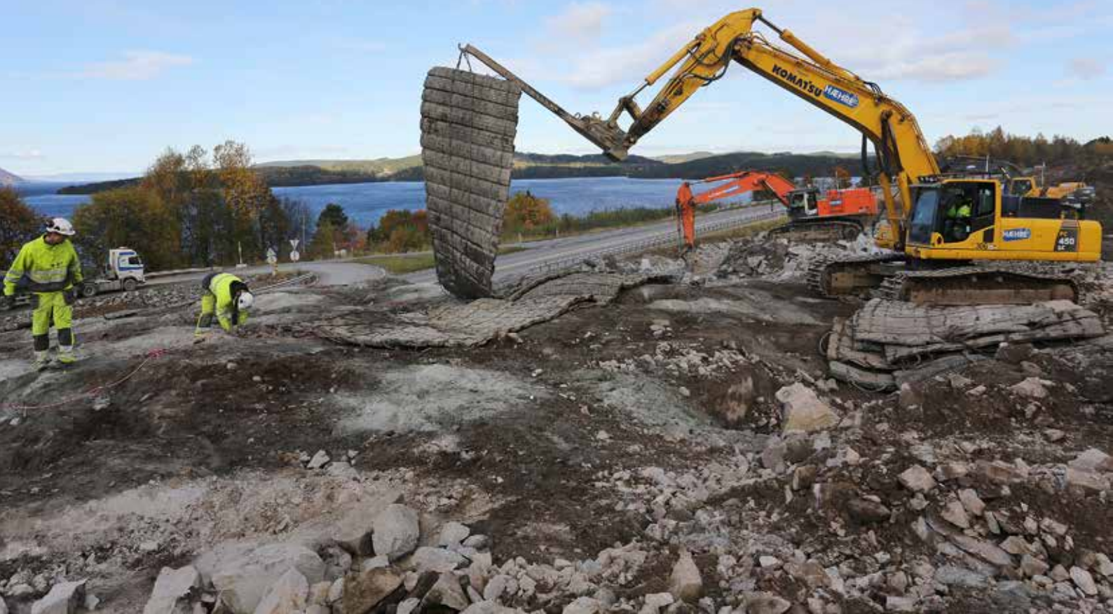
Bergknausene langs gamle E6 forsvinner fort i disse dager. En ny salve er klar og skytemattene legges varsomt på plass over Exelslangene på Espå.
