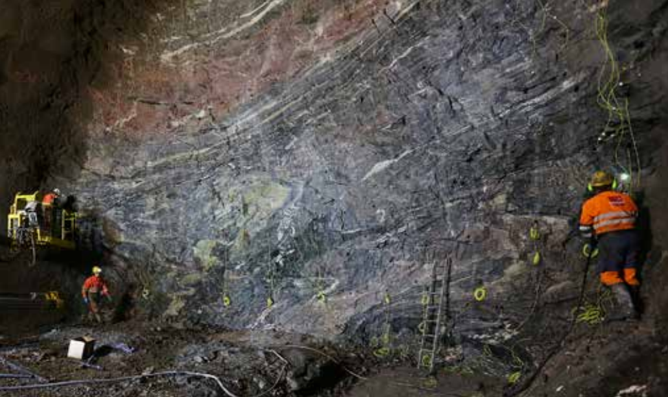
Stuffen i Ulvintunnelen på nye Dovrebanen. Jernbanetunnelen har et tverrsnitt på 125 meter. Høyde og bredde er 12 meter. Bergartene og lagdelingene i fjellveggen danner et storslått maleri.
